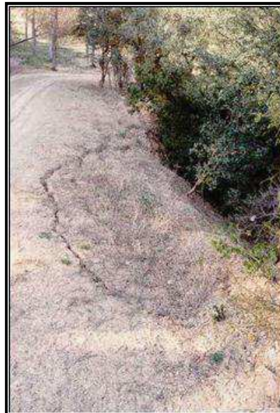
Deslizamiento en el talud de un camino cerca de Peralta.
